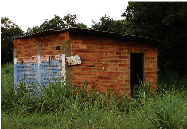
Figura 44 – Quadra 605 Sul, ruínas do in concreto – construção abandonada. Fotografia tomada em 12 de janeiro de 2007.
