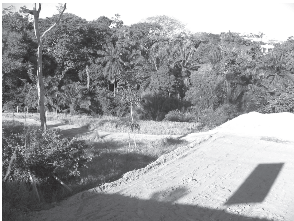
Obras em empreendimentos na Avenida Paralela. Apesar do discurso sobre a natureza, observa-se um avanço da área construída sobre os remanescentes da Mata Atlântica e recursos hídricos (Áreas de Preservação Permanente)
